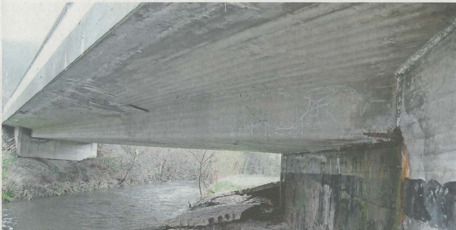
Von unten werden die Schäden an der Erfbrücke in Eichenbühl deutlich. Im Haushalt hat die Gemeinde für eine Sanierung 100 000 Euro vorgesehen.
