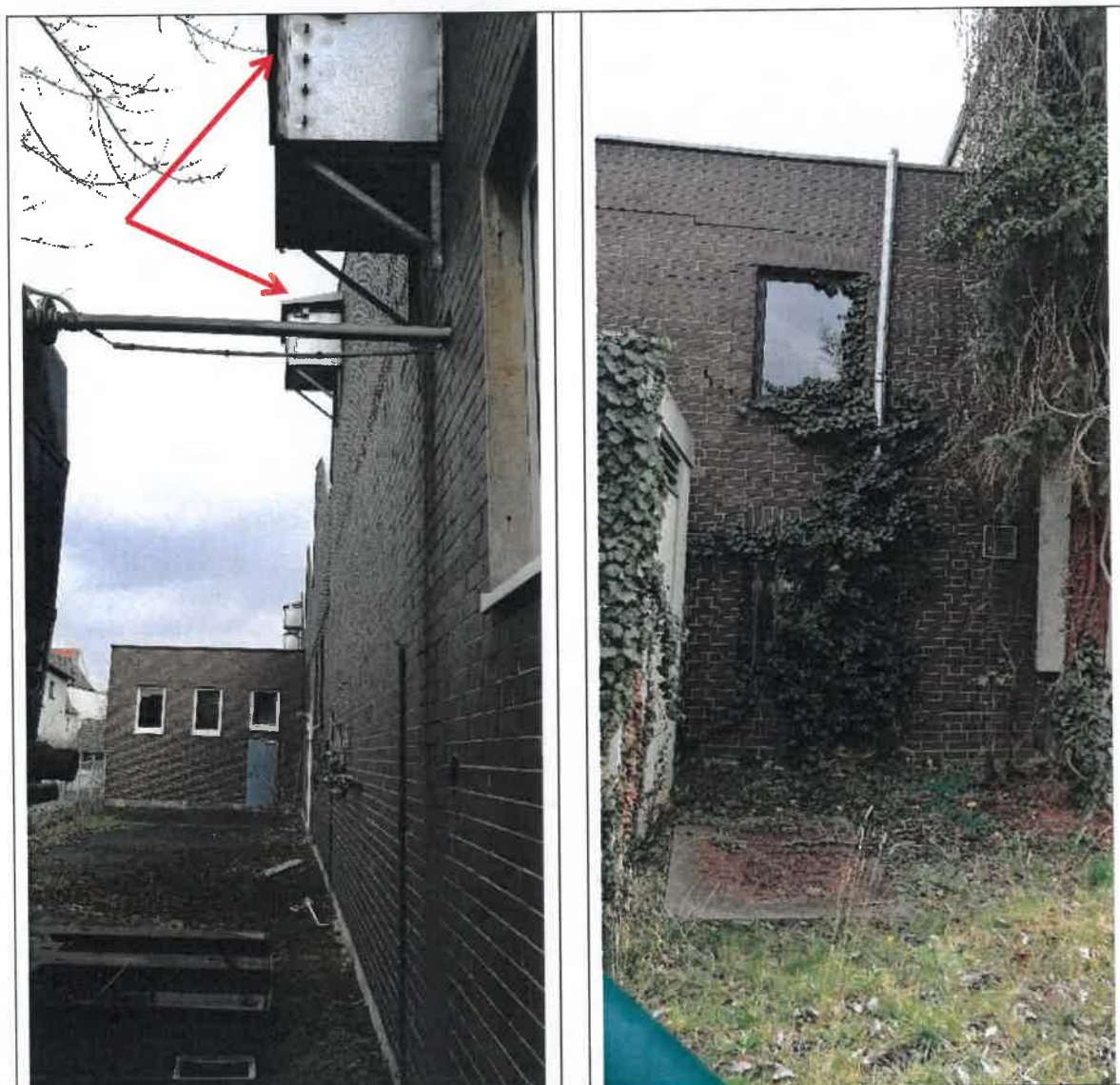
Abb. 24: Lüftungsausgänge und Gebäudenischen als potenzielle Niststätten
