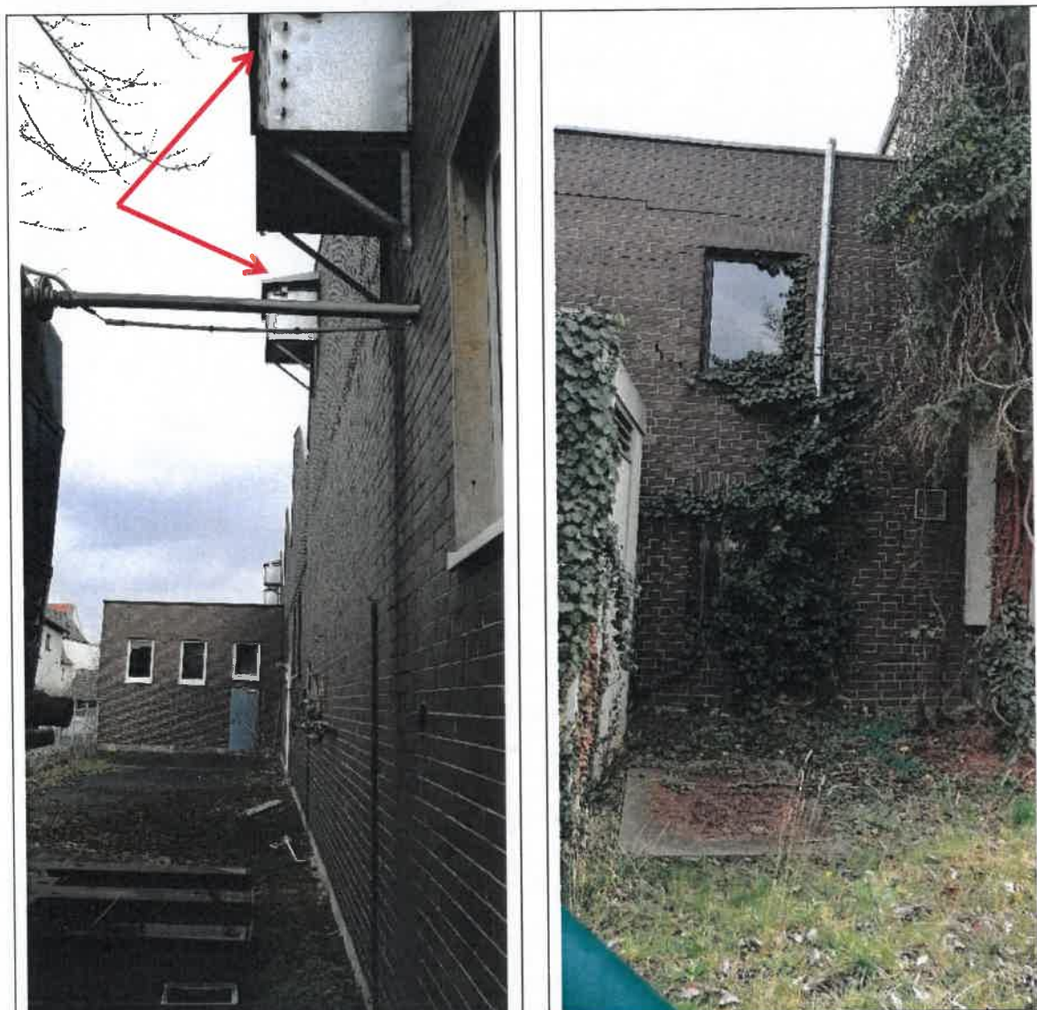
Abb. 24: Lüftungsausgänge und Gebäudenischen als potenzielle Niststätten
