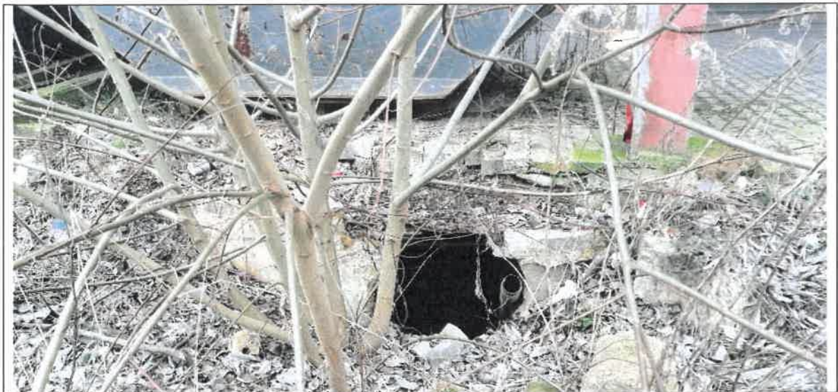
Abb. 10: Hohlraum unter Flur im Bereich der Ladezone
