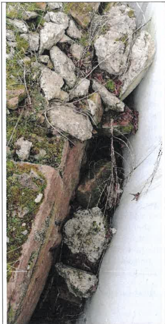
Abb. 11: Spalt zwischen Hochwasserschutzmauer und Gelände mit Steinmaterial
