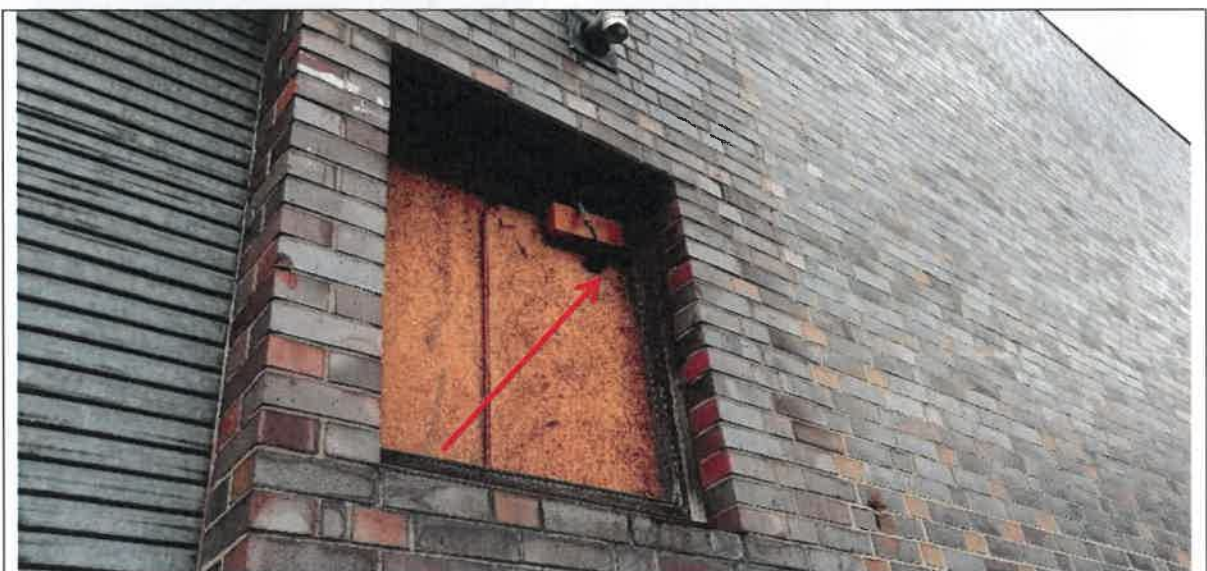
Abb. 22: Unvollständig verschlossene Fensteröffnung
