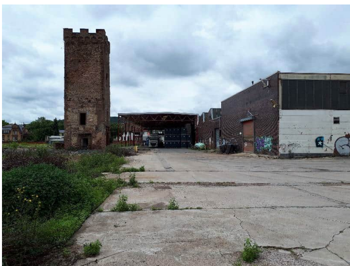
Die Sheddach Halle beim Turm mit dem Vordach, das zurückgebaut wird. In der Umsetzungsphase 2 wird der Flachdachbau und der erste Shed zurückgenommen. Hier entsteht dann die Verlängerung der Rathausstraße und das Baufeld ③
